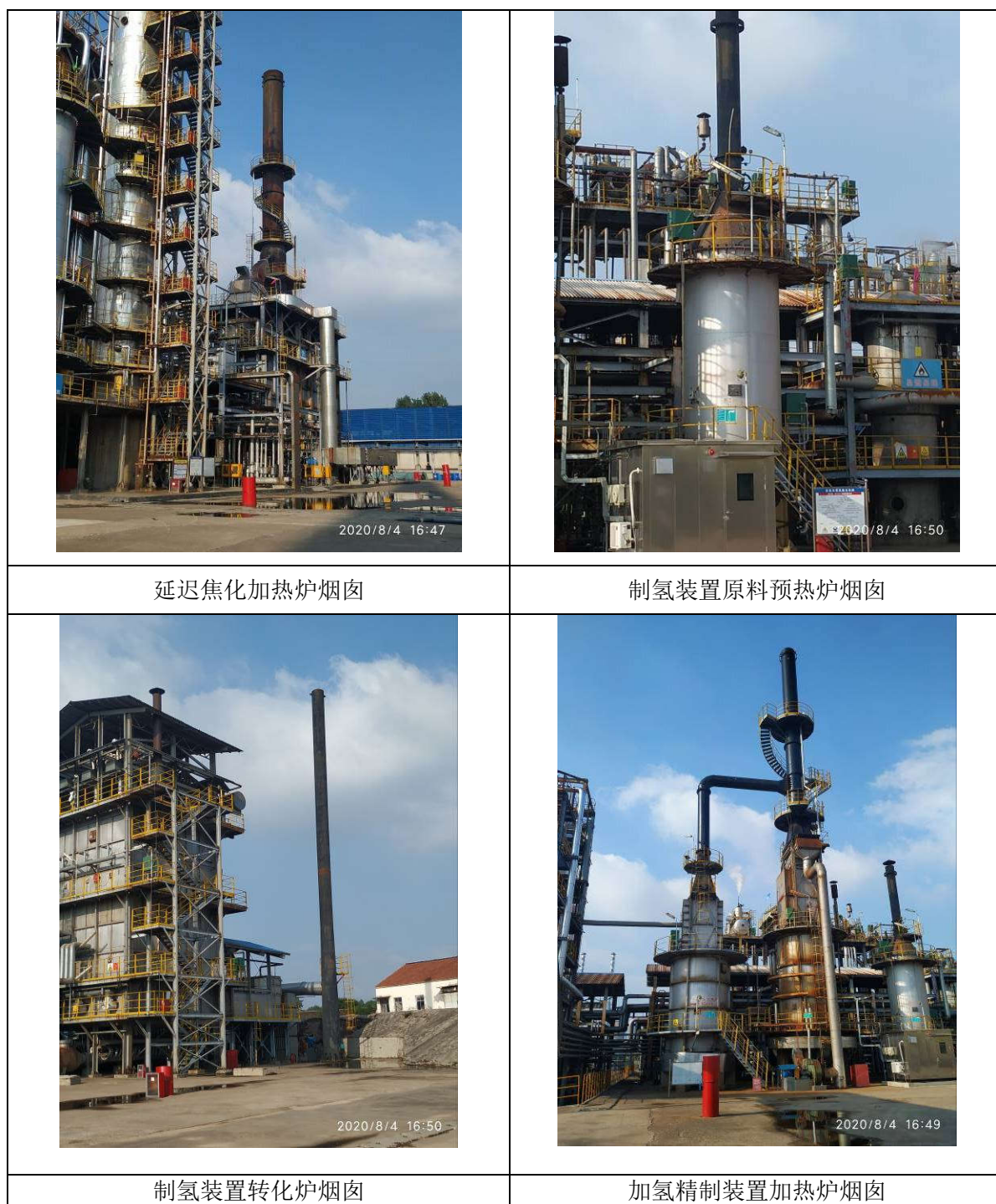
图4.1-1 项目有组织废气治理设施
