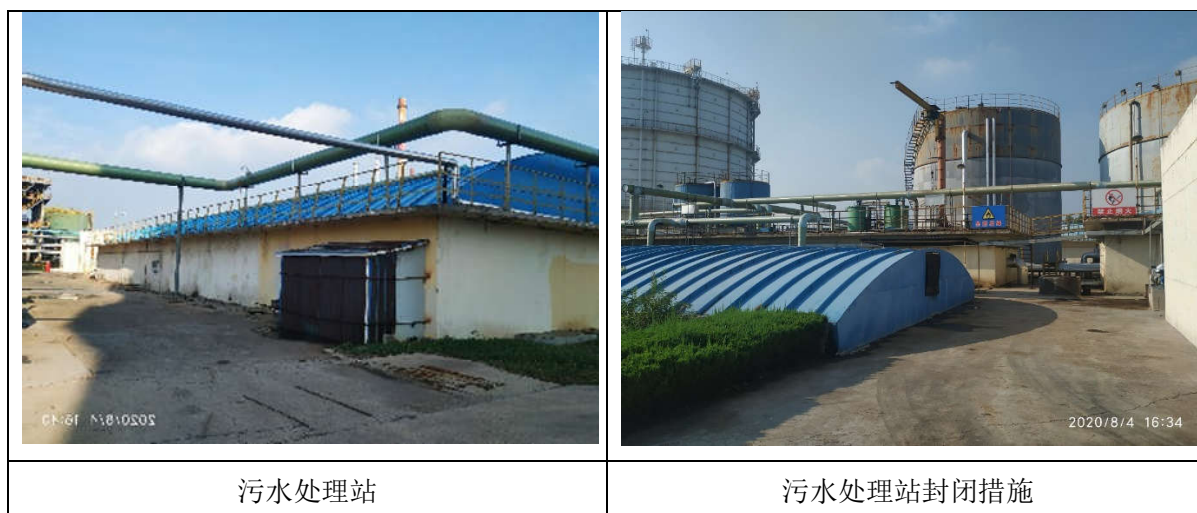
图4.1-2 项目依托废水治理设施
