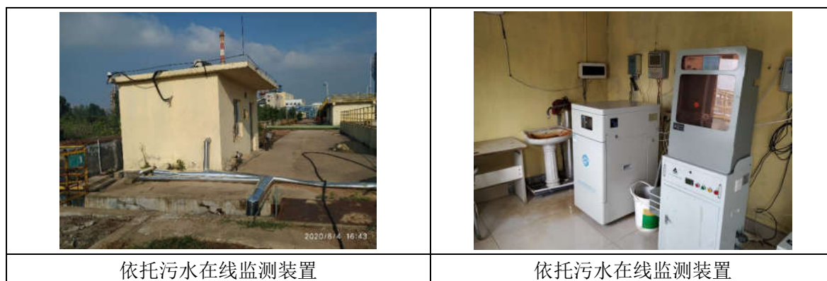
图 4.2-10 污染物排放口在线系统安装情况
