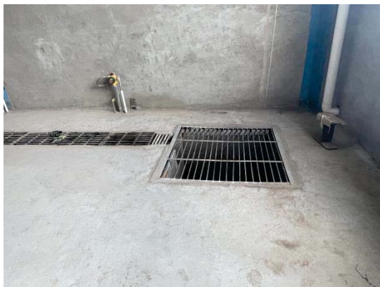
危废暂存间 2-内部导流
