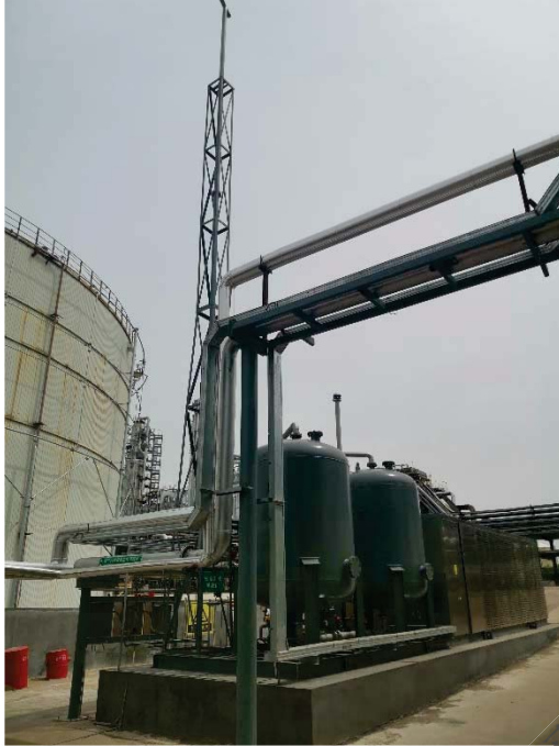
油气回收装置
